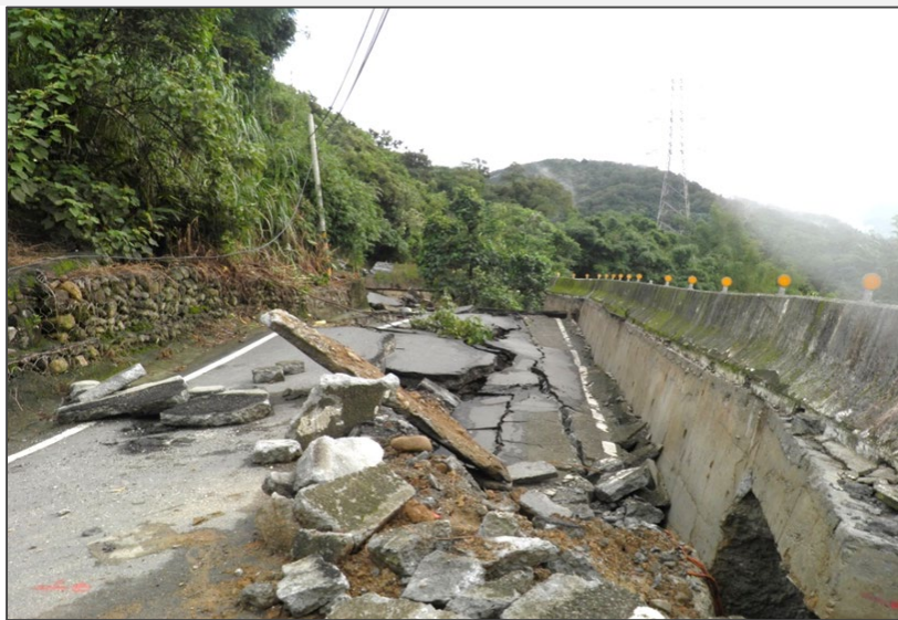
道路坍塌情形
