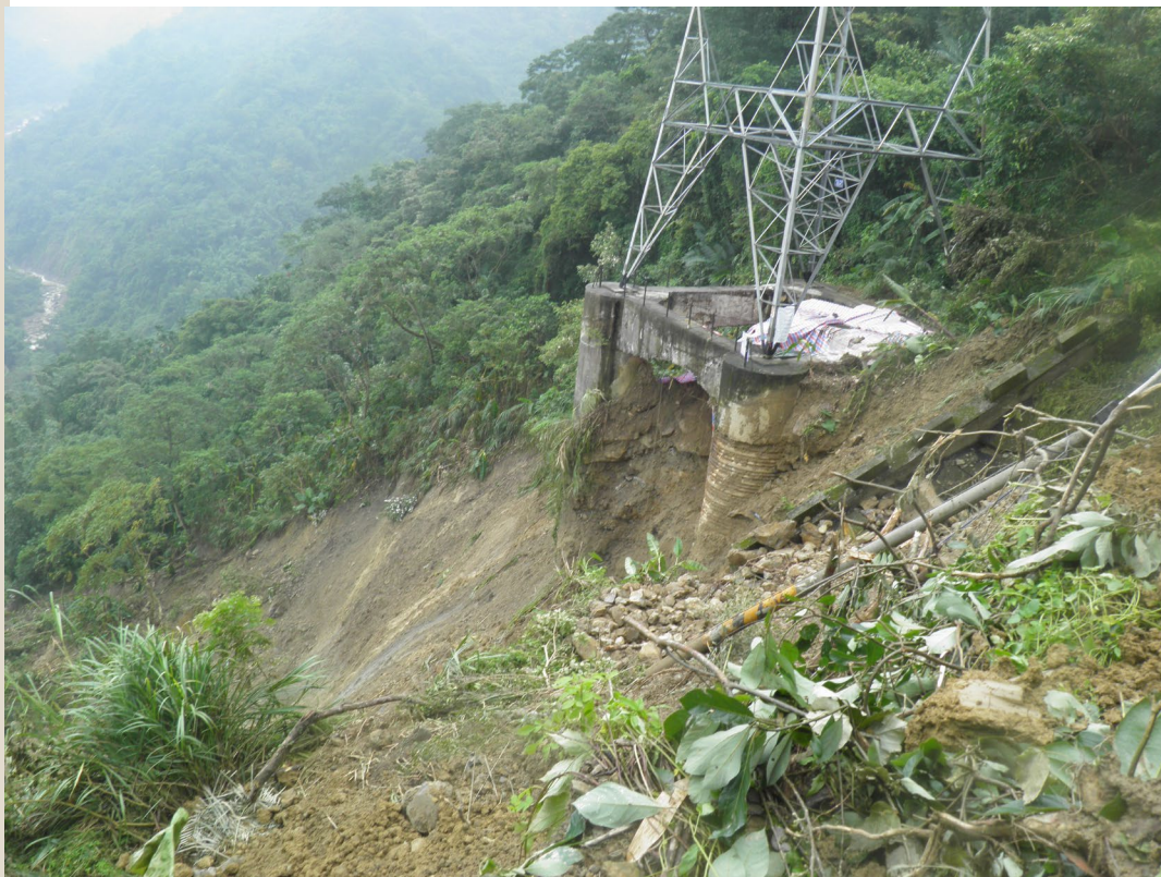
345kV大觀中寮一、二路14塔基坍方
