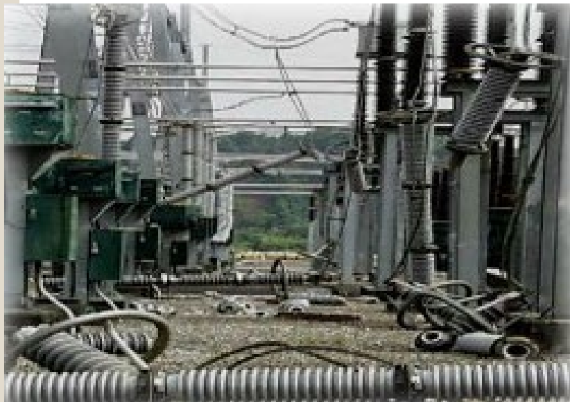
921地震重創變電設備 (中寮變電所)
