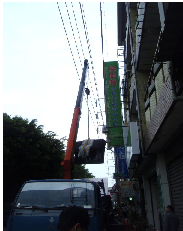
吊卡車吊掛鋼琴時，未與導線保持安全距離閃絡事故(人員傷亡)
