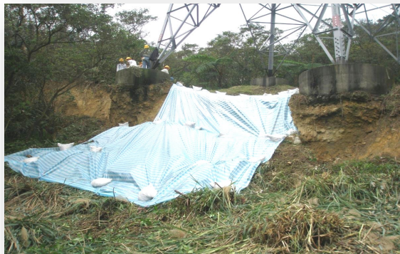
塔基崩塌先覆蓋帆布以防崩塌 面積擴大
